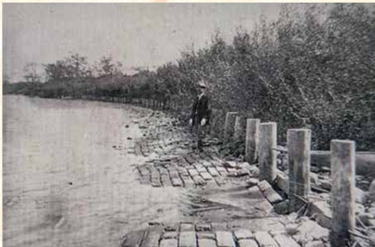
岡崎は高機能・低コストな護岸ブロックも考案。鉄筋コンクリートブロックに金属ワイヤーを通してつなぎ、米国ミシシッピ川でも約1,600kmにわたって敷設されている。写真は石狩川
